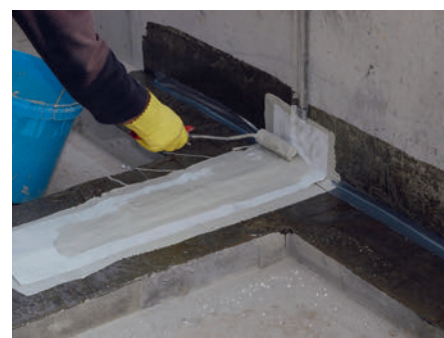
Frisch in frisch arbeiten Abdichtungsspezialisten die Vliesarmierung in den Flüssigkunststoff ein. Dadurch ist das überlappende System elastisch und unterlaufsicher.
