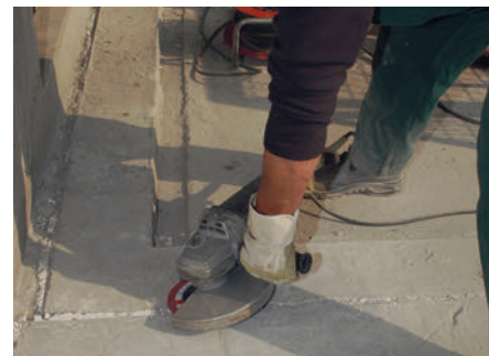
Für WU-Betonfugen eignen sich speziell entwickelte Abdichtungssysteme auf Polymethylmethacrylat-Basis (PMMA). Um diese auf den vorhandenen Belag aufzubringen, schleifen Fachverarbeiter den Beton zunächst an.
