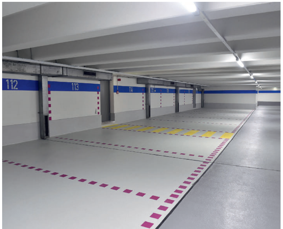
Flüssigkunststoff bietet durch den Einsatz unterschiedlicher Farbtöne in der Versiegelung vielseitige Gestaltungsmöglichkeiten. So lässt sich auf Wunsch die Corporate Identity des Betreibers optisch umsetzen. Vielmehr jedoch dient die farbliche Markierung von Parkbuchten, Geh- und Fahrwegen der Sicherheit der Kunden.
