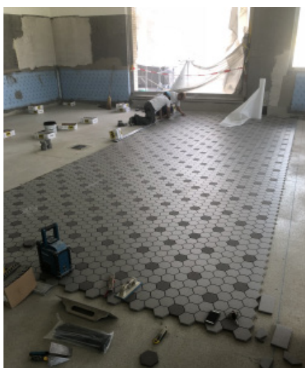
Die Verlegung der Bodenplatten erfolgte mit Einstreuer (Fläche mit dem Einlegen einer anderen Farbe optisch aufgelockert)
