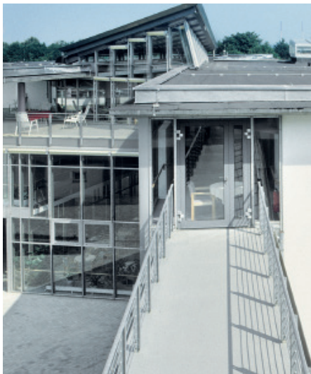
Balkone, Terrassen und Laubengänge sind oftmals als Fluchtwege ausgewiesen und müssen den Brandschutz-Bestimmungen entsprechen. Die S1-Varianten Triflex erfüllen die Anforderungen, da sie dank spezieller Additive schwer entflammbar sind.
