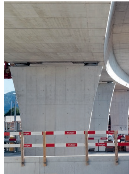
Für die Alpenbrücke in Thun wurde MAPEFORM ECO 91 eingesetzt, um schöne Sichtbetonoberflächen zu erzielen
