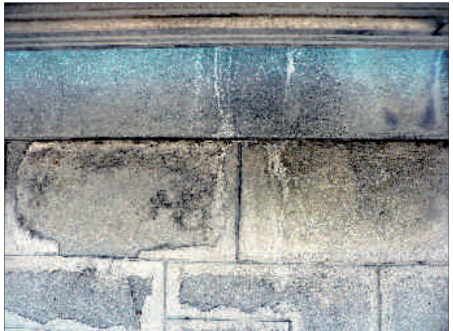
Bild 5: Hohllage und schalenartige Ablösung des Kunststeins vom Originalsandstein
