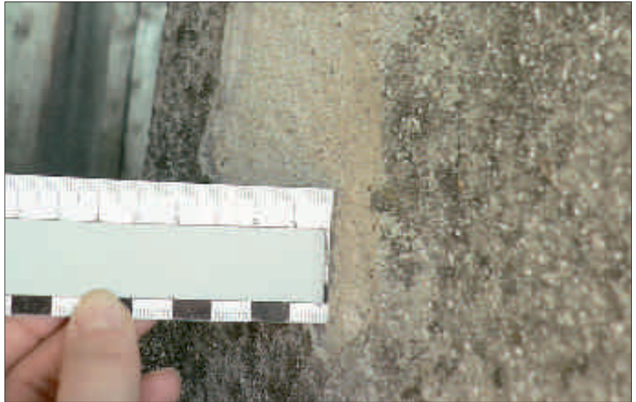
Bild 6: Verstärkte Rückwitterung des Sandsteins durch den nicht angepassten, zementreichen «Fugenverputz»
