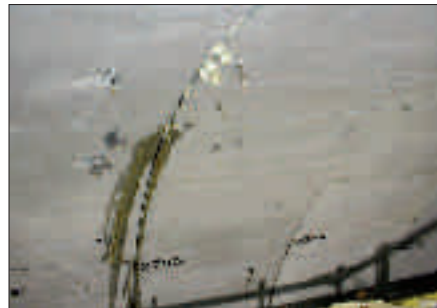
Bild 6: Partielle Austritt von Elastomerschaum aus einer Tübbingfuge
