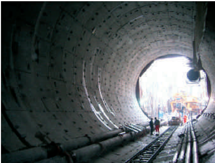
Bild 9: Partieller Wassereintritt in den SMART-Tunnel, Kuala Lumpur
